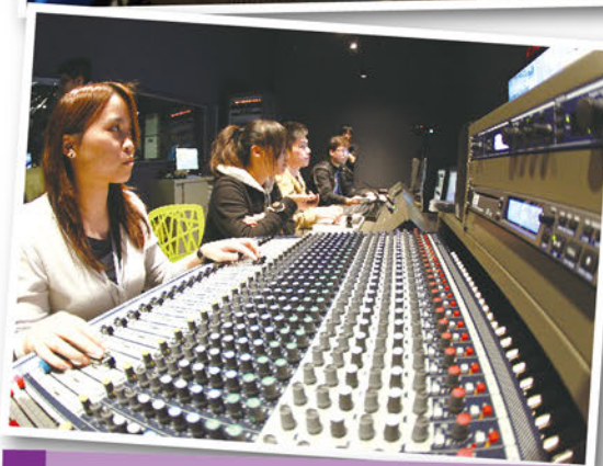
高清影視製作錄影廠及控制室，可進行多元化節目製作實習
